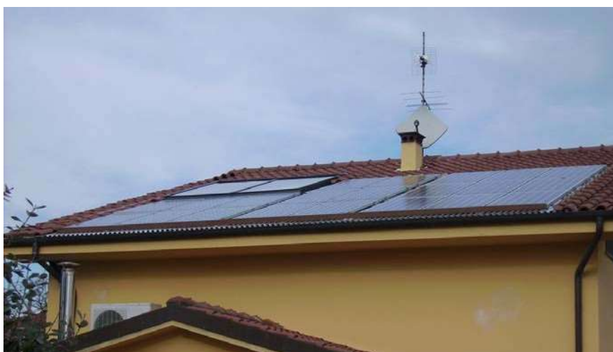
Zdjęcie 99: Zdjęcie paneli słonecznych zainstalowanych na dachu domu zgodnie z technicznymi przepisami budowlanymi.
