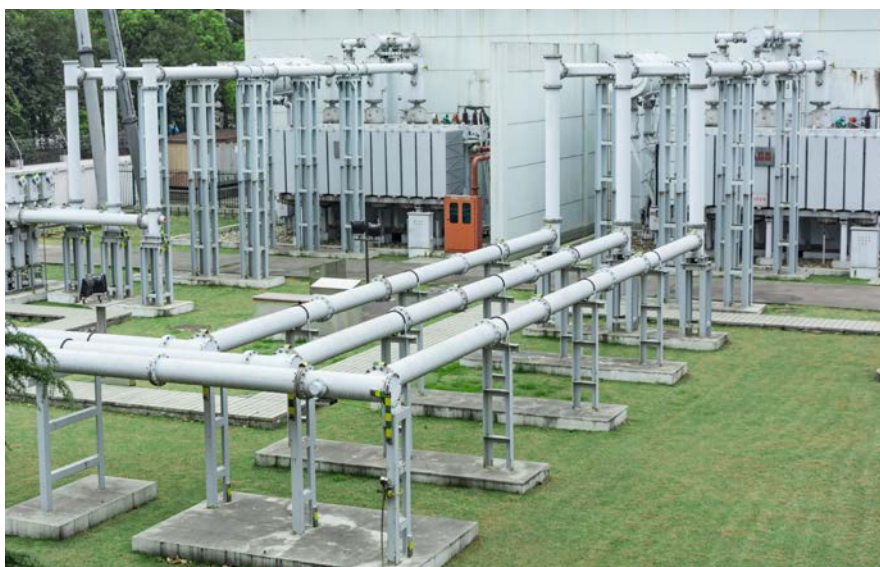
Imagen 93: Fotografía de una minicentral hidráulica.
